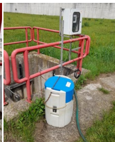
Vzorkování vyčištěné odpadní vody na odtoku z ČOV
